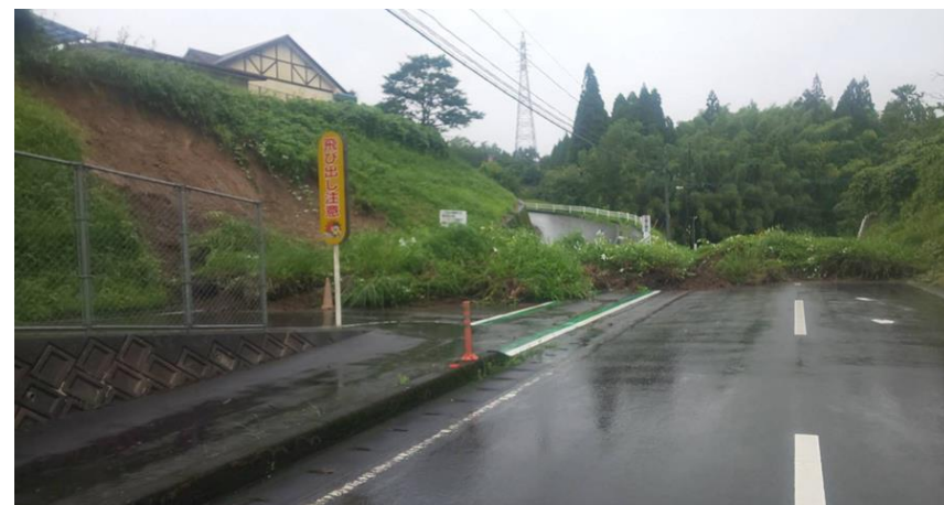
須恵 町道小学校線 土砂崩れ
