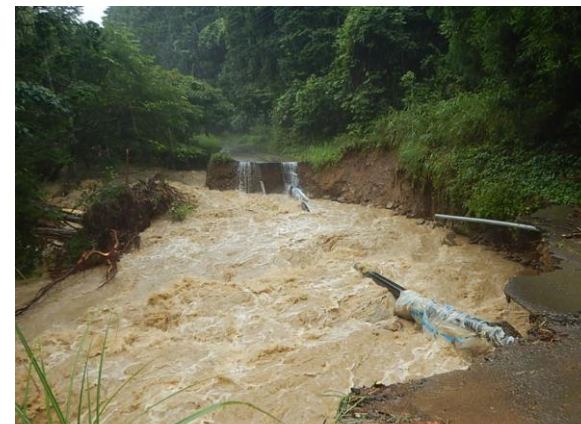
岡原 林道 黒原線 宮原川洗堀による崩落
