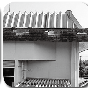
あさぎり中学校体育館の 屋根材の剥がれ
