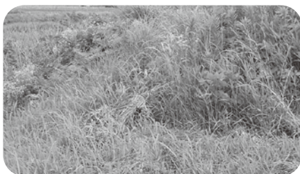
雑草が繁茂した井口川の堤防
