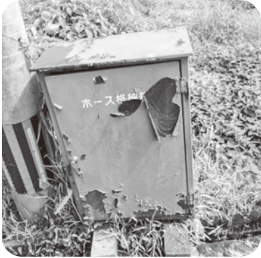
老朽化した消火ホース格納箱
