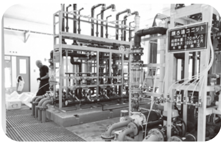
岡原第2水源の膜ろ過装置
