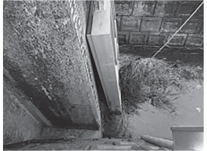
▲水路を流れた草が球磨川への排水門に詰まっている状況
