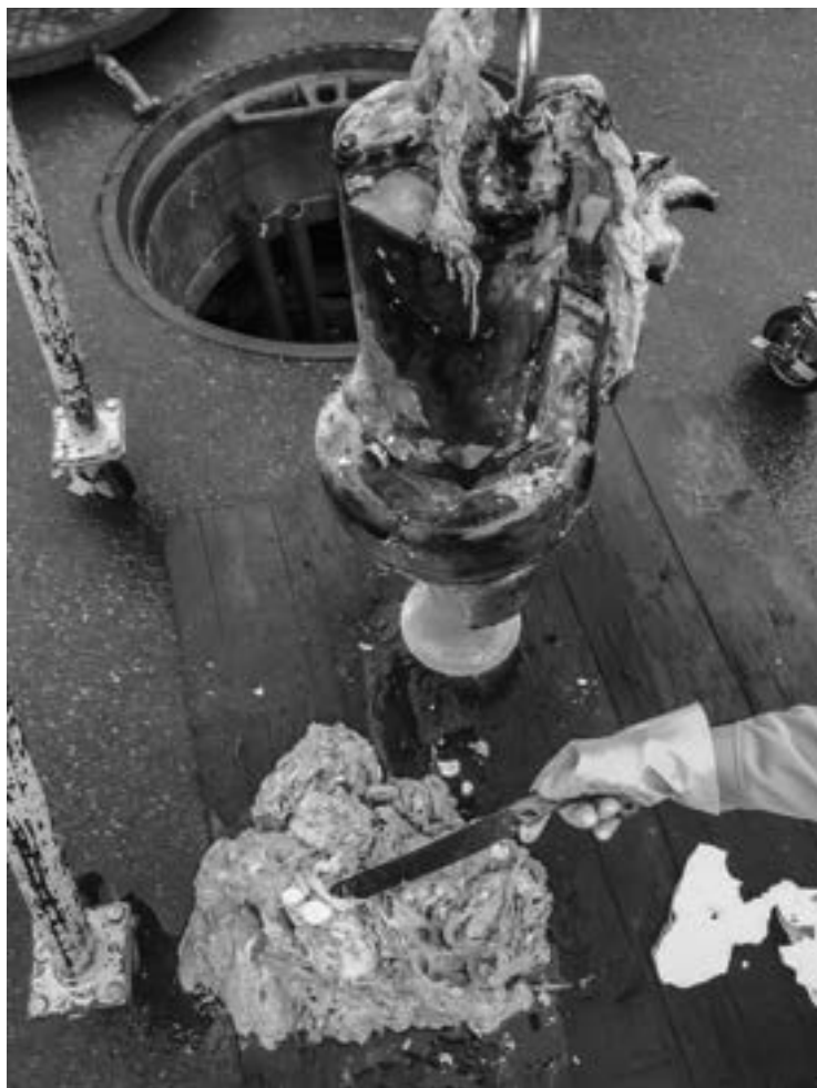
▲下水道に流されたビニール袋やティッシュなどがポンプに巻き付き故障させます
