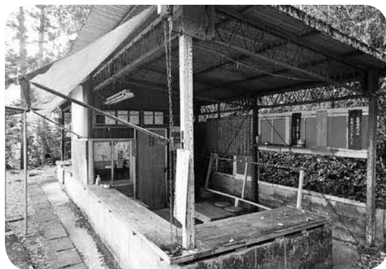
老朽化している射撃場
