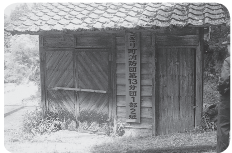
老朽化した詰所
