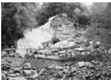
台風14号による被害状況 (林道榎田～大川筋線)
