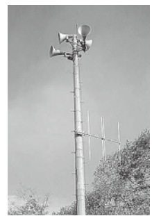
老朽化した防災無線
