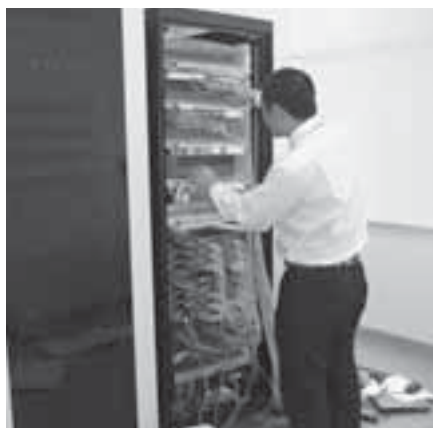
情報基盤整備 (旧上庁舎内のセンター設備)
