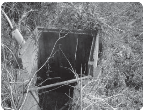
老朽化している用水路
