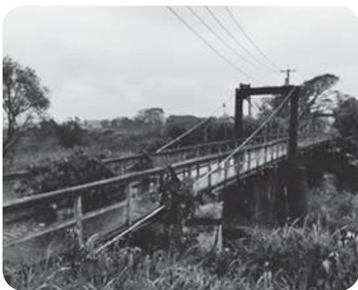
通行止め解除が待たれる吊り橋(石田橋)
