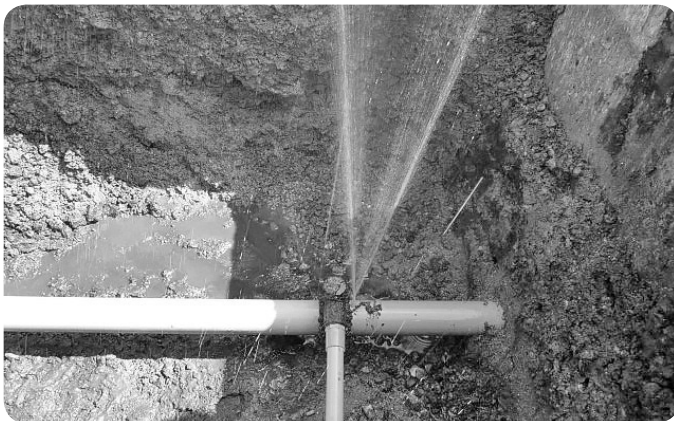
老朽化による漏水が増えている配水管(免田地区)
