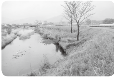
免田川堤防の損壊箇所
