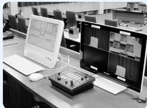
議会中継配信システムの操作盤
