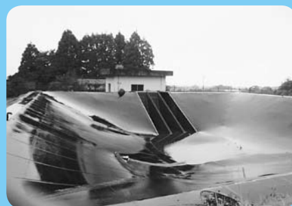
上南観測ろ過装置
