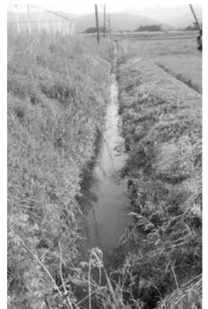
改修が待たれる排水路
