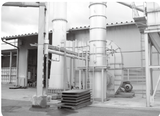
(株)熊本製材のボイラー
