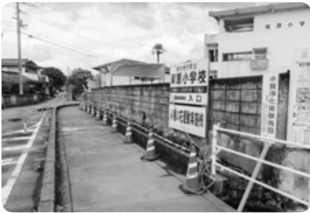
危険と判断した岡原小のブロック塀
