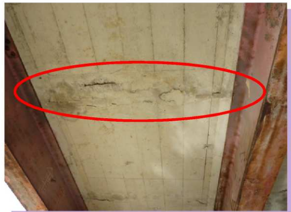
床版のひびわれ, 剥離・鉄筋露出
