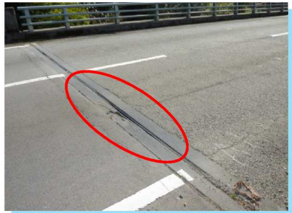
伸縮装置の破損
