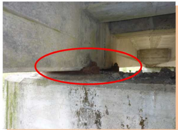
支承の腐食, 土砂詰り
