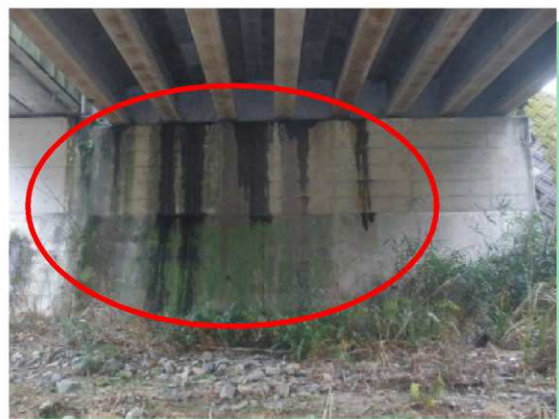
橋台への漏水
