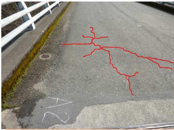
舗装のひびわれ
