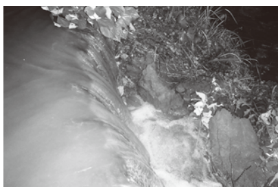
溢水のため町道の路肩が崩落した瞬間
