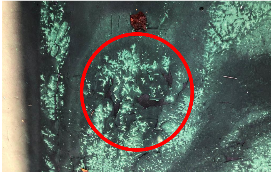
一部剥がれかかった状態の屋根
