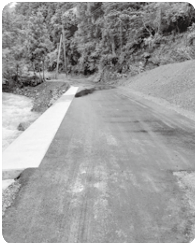
復旧された岡原水源
