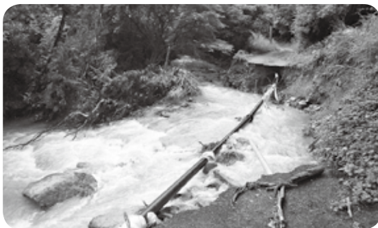
令和2年7月豪雨災害状況（岡原水源）
