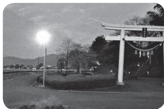
LED化された防犯灯
