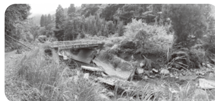
林道西平線 災害状況
