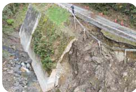
町道立野線被害状況
