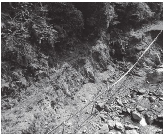
▲取送水設備に続く管理道路の崩壊
