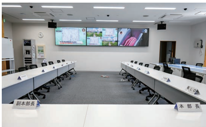
▲大型モニターが備わった災害対策室
