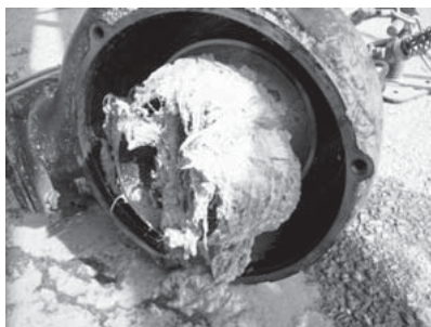
☆ポンプ停止（布の詰まり）
