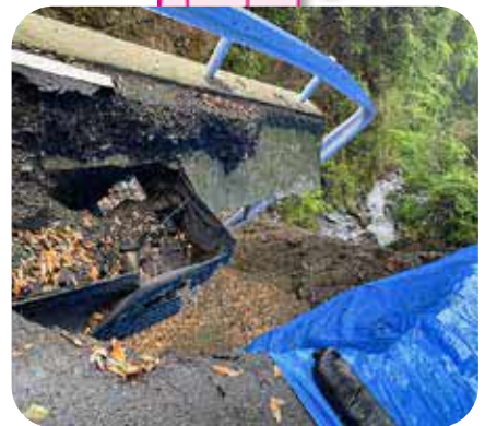
皆越立野線崩落箇所
