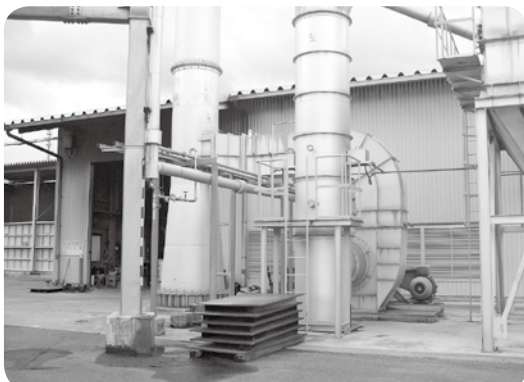
(株)熊本製材のボイラー
