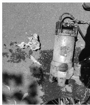
▲ビニール袋やティッシュなどがポンプに巻き付き故障させます
